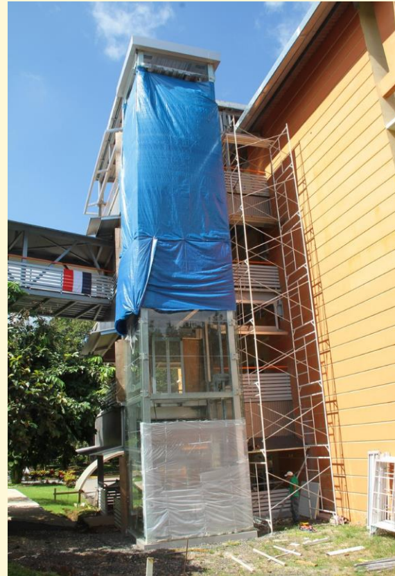
Ascensor Edif. 3 y Edif. 1
